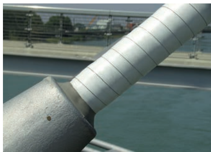
Bild 13. Anschluss an der Verankerung am Überbau Fig. 13. Joining at the deck anchorage
