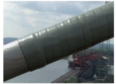
Bild 19. Anschluss des Korrosionsschutzes an der Überbauverankerung Fig. 19. Joining of the tapes at the deck anchorage
